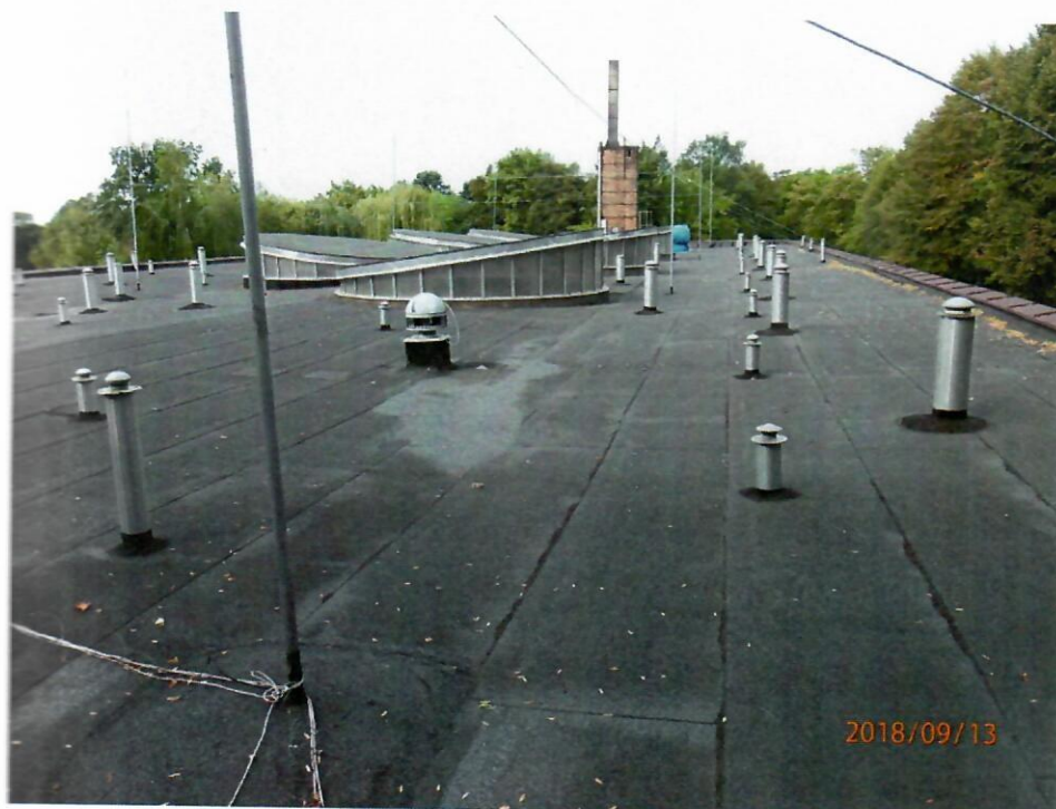
Fot. 2. Inne ujęcie pokrycia papowego na dachu pawilonu dydaktycznego. Niewielkie ślady po zastoiskach wody opadowej wskazują na konieczność poprawy spadków dachu.
