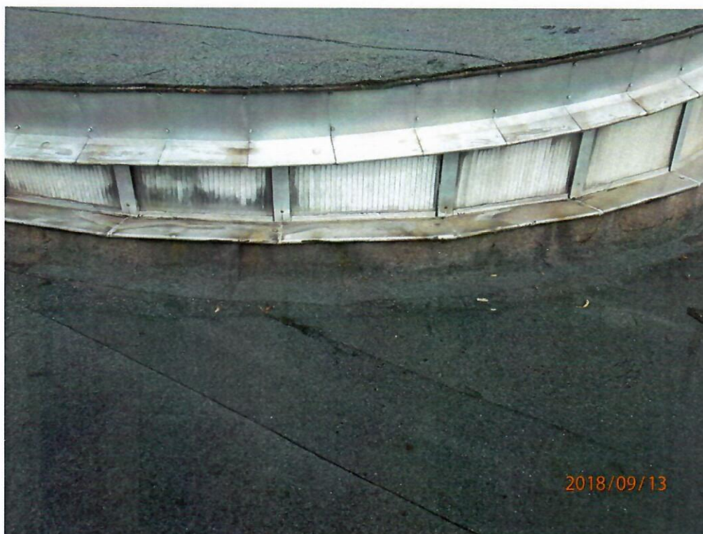
Fot. 23. Biały kolor płyt poliwęglanowych świadczy o zaparowaniu przestrzeni komór, a to dowodzi braku szczelności opraw płyt w ramach.
