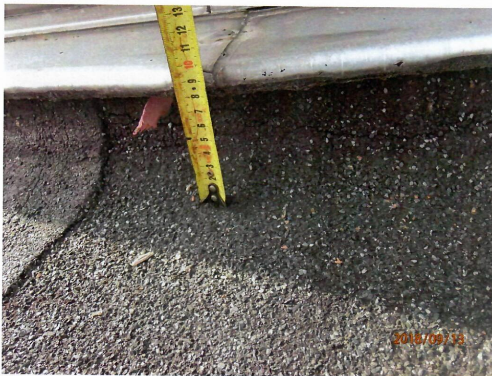
Fot. 21. Mała wysokość ścianki kolankowej świetlika może być przyczyną penetracji wody z topniejącego śniegu do wnętrza budynku.
