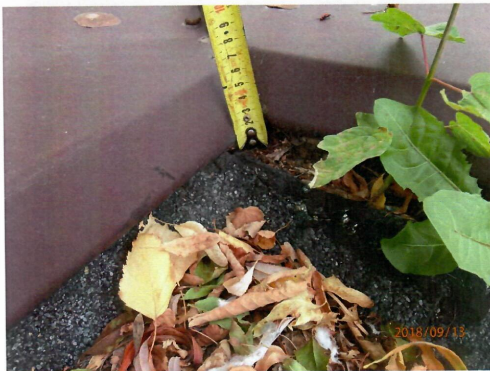
Fot. 8. Inne miejsce odklejenia od ścianki attyki od strony południowej paska papy. Duża wilgoć pod pasem papy sprzyja rozwojowi flory. Zbyt niska ścianka kolankowa. Powyższa usterka jest typowa dla tego dachu i występuje praktycznie na całym obwodzie budynku.
