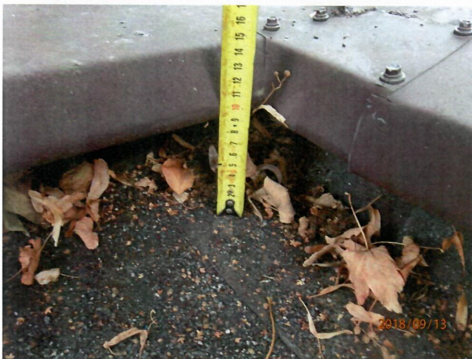
Fot. 4. Narożnik południowo-wschodni attyki. Widoczna zbyt mała wysokość ścianki pionowej uniemożliwiająca wykonanie prawidłowej obróbki z papy (minimalna wysokość powinna wynosić 10 – 15 cm). Źle wyprofilowane zakończenie obróbki blacharskiej.
