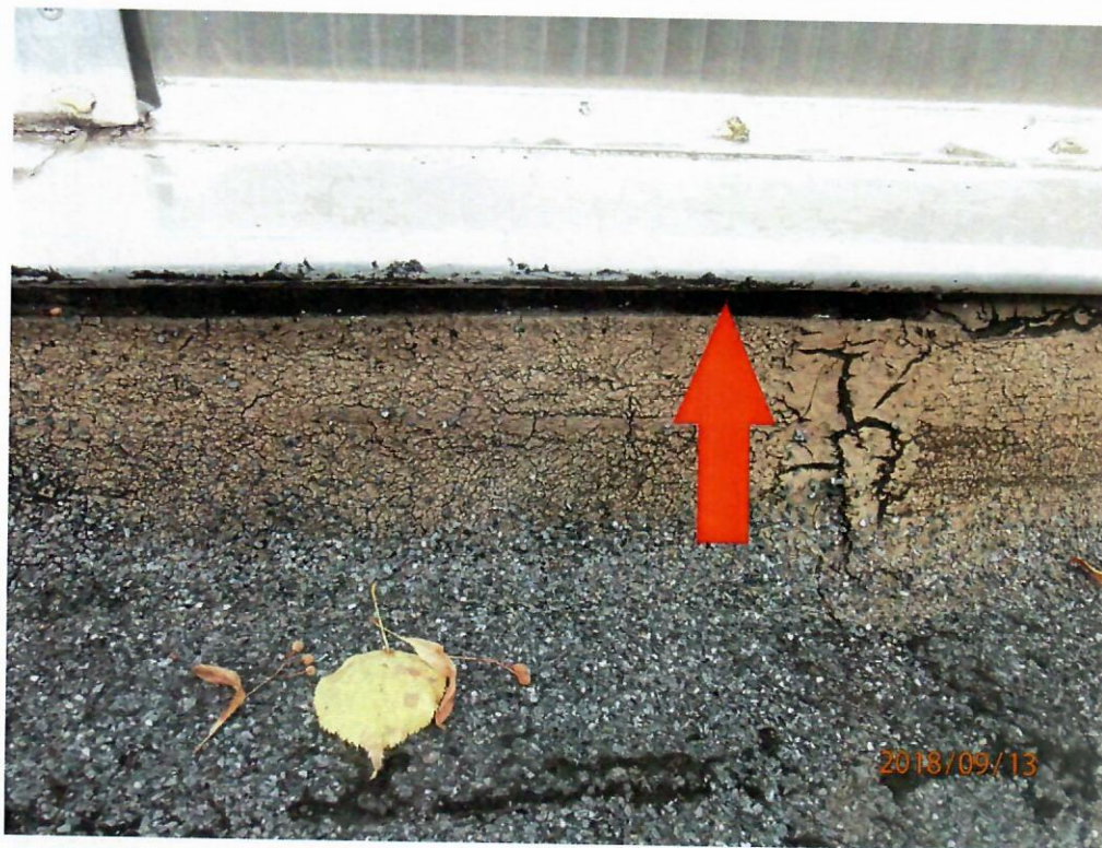
Fot. 34. Inne miejsce złego wykonania izolacji ścianki kolankowej świetlika. Spływająca z obróbki blacharskiej woda wlewa się bezpośrednio pod papę.
