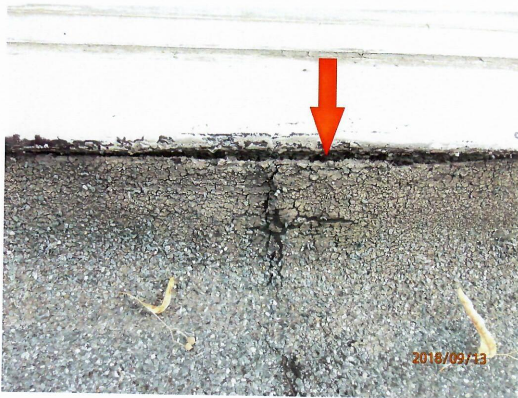
Fot. 33. Inne miejsce złego wykonania izolacji ścianki kolankowej świetlika. Spływająca z obróbki blacharskiej woda wlewa się bezpośrednio pod papę.
