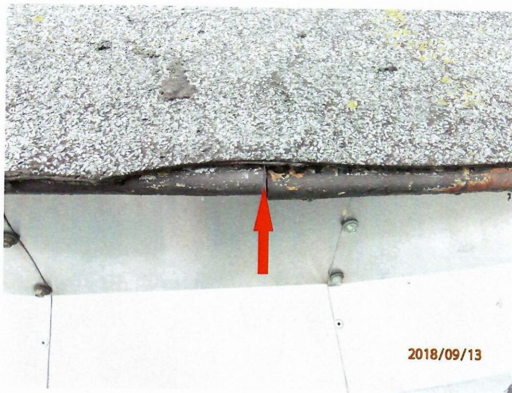
Fot. 25. Inne miejsce braku ciągłości obróbki blacharskiej.
