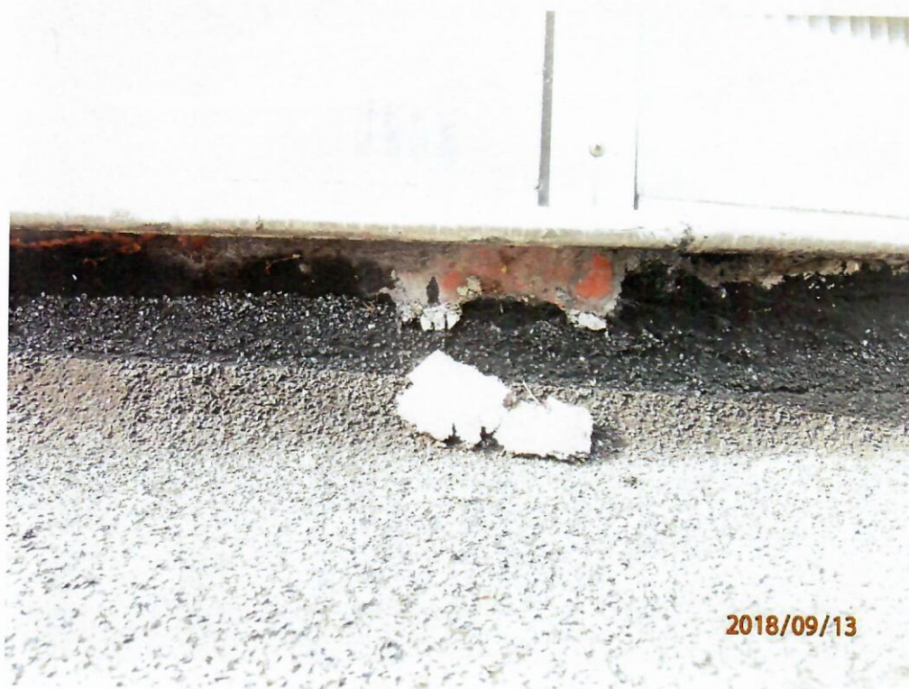
Fot. 26. Odpadający tynk ze ścianki kolankowej, destrukcja elementów ceramicznych.
