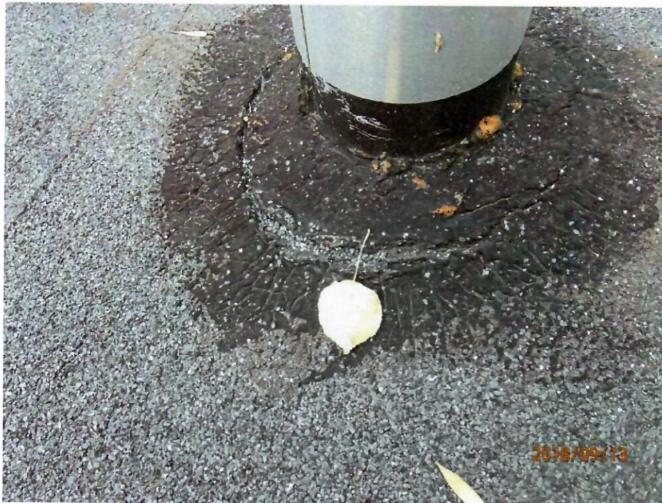
Fot. 11. Typowa usterka pokrycia z papy w miejscach przechodzenia wywiewzaków przez dach – prawdopodobna przyczyna nieszczelności pokrycia. Pękanie pokrycia z papy wskazuje na niską jakość użytego tego materiału. Nieprawidłowo wykonana obróbka wywiewki.
