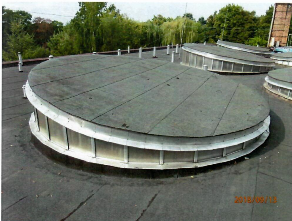
Fot. 3. Widok ogólny dachu na jednym z ośmiu świetlików. Widoczne obróbki blacharskie i okna z poliwęglanem. Zbyt niski dolny cokół podokienny świetlika.
