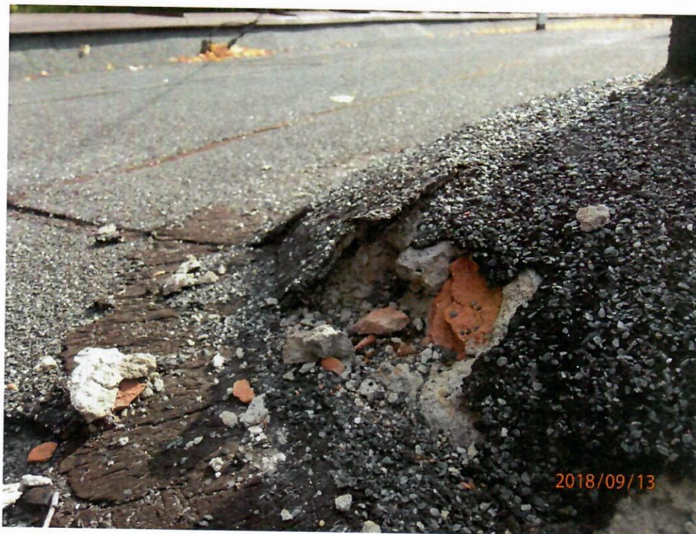
Fot.17. Uszczegółowienie miejsca z poprzedniej fotografii. Na skutek wilgoci destrukcji ulega odbój wykonany z zaprawy i cegły potęgując proces penetracji wody opadowej.
