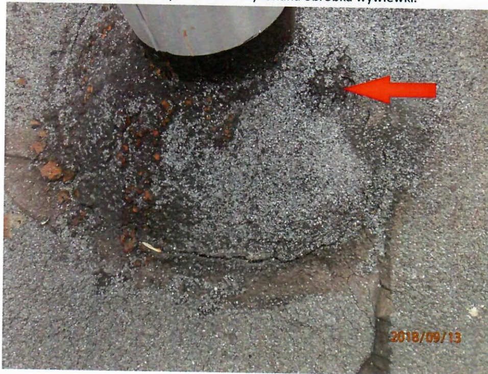
Fot. 14. Typowa usterka pokrycia z papy w miejscach przechodzenia wywiewzaków przez dach – prawdopodobna przyczyna nieszczelności pokrycia. Pęknienie pokrycia z papy wskazuje na niską jakość użytego tego materiału. Nieprawidłowo wykonana obróbka wywiewki.
