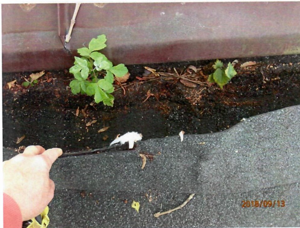
Fot. 7. Inne miejsce odklejenia od ścianki attyki od strony południowej paska papy. Duża wilgoć pod pasem papy sprzyja rozwojowi flory. Powyższa usterka jest typowa dla tego dachu i występuje praktycznie na całym obwodzie budynku.
