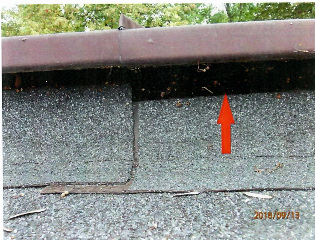
Fot. 6. Inne miejsce odklejenia od ścianki attyki paska papy. Powyższa usterka jest typowa dla tego dachu i występuje praktycznie na całym obwodzie budynku.
