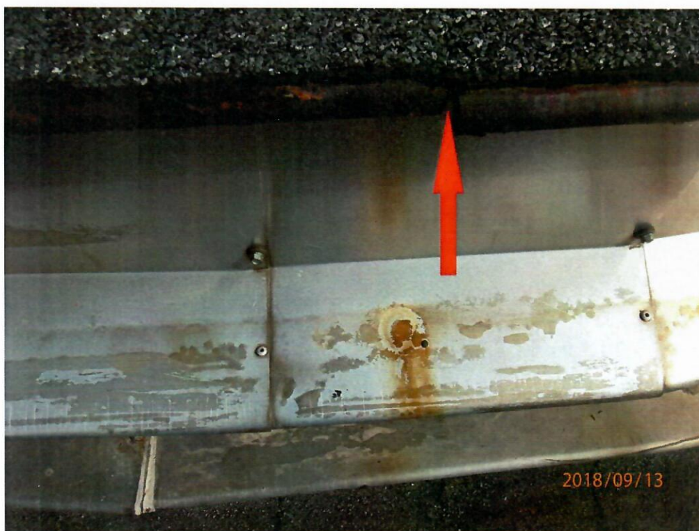
Fot. 24. Arkusze blachy okapowej świetlików nie zachowują ciągłości.
