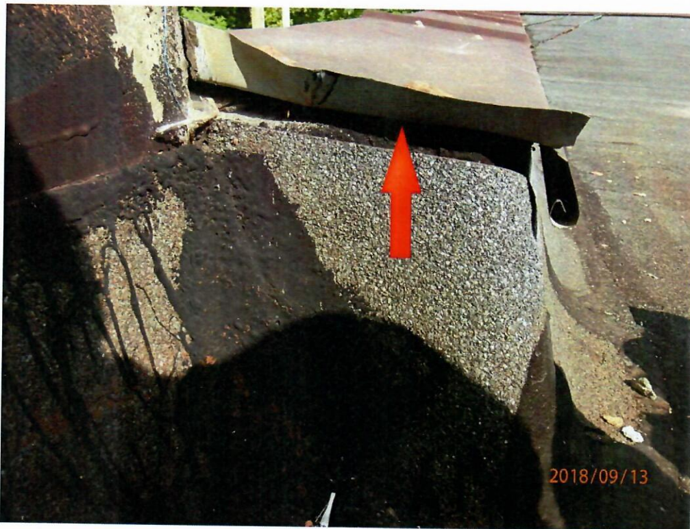
Fot. 39. Brak wykończenia obróbki blacharskiej na ścianie kolankowej obok komina kotłowni
