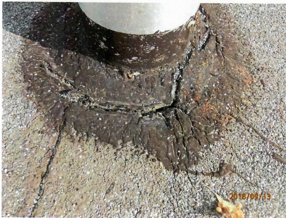
Fot. 12. Typowa usterka pokrycia z papy w miejscach przechodzenia wywiewzaków przez dach – prawdopodobna przyczyna nieszczelności pokrycia. Pękanie pokrycia z papy wskazuje na niską jakość użytego tego materiału. Nieprawidłowo wykonana obróbka wywiewki.
