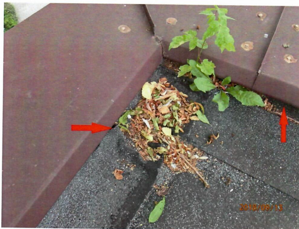
Fot. 9. Strzałki pokazują miejsca penetracji wody opadowej pod fartuch z papy. Powyższa usterka jest typowa dla tego dachu i występuje praktycznie na całym obwodzie budynku.
