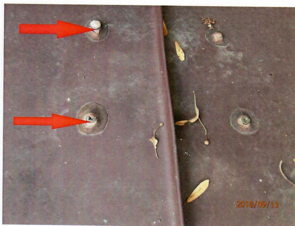
Fot. 36. Nieodpowiedni sposób mocowania obróbki poziomej ścianki kolankowej. Zastosowanie zwykłych wkrętów bez uszczelek i zabezpieczenie silikonem jest rozwiązanie nieprawidłowym.
