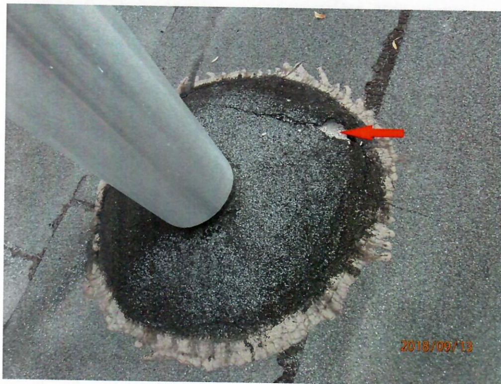
Fot. 18. Inne miejsce przechodzenia wywiewzaka przez dach. Uszkodzenie powłoki bitumicznej – przyczyna przeciekania wody opadowej. Nieprawidłowo wykonana obróbka wywiewki.
