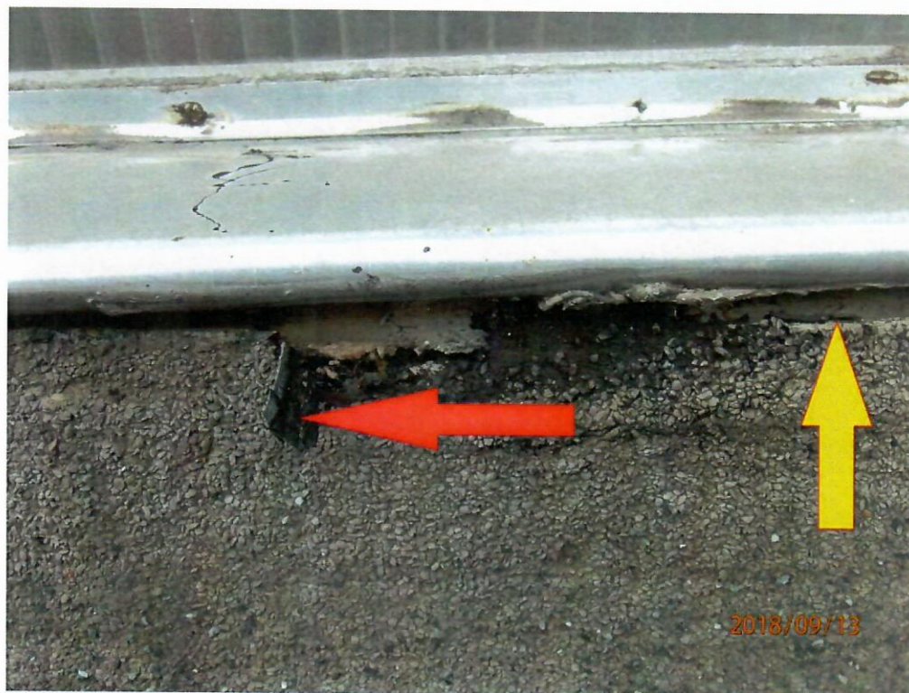
Fot. 28. Usterki izolacji ścianki kolankowej świetlika. Strzałka czerwona pokazuje uszkodzenie mechaniczne papy, strzałka żółta – odspajanie papy od ścianki kolankowej. Są to przyczyny penetracji wody opadowej.
