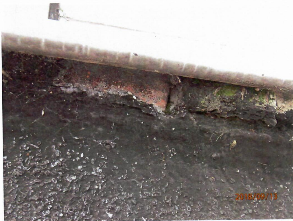
Fot. 29. Ubytek tynku na zbyt niskiej ścianie kolankowej świetlika – przyczyna penetracji wód opadowych
