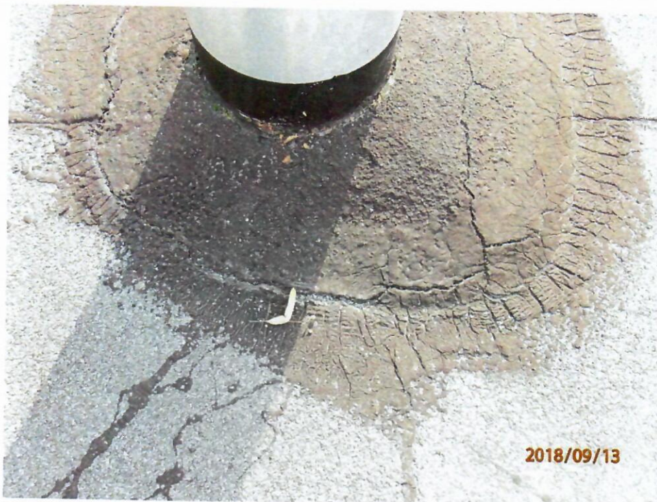
Fot. 13. Typowa usterka pokrycia z papy w miejscach przechodzenia wywiewzaków przez dach – prawdopodobna przyczyna nieszczelności pokrycia. Pęknienie pokrycia z papy wskazuje na niską jakość użytego tego materiału. Nieprawidłowo wykonana obróbka wywiewki.
