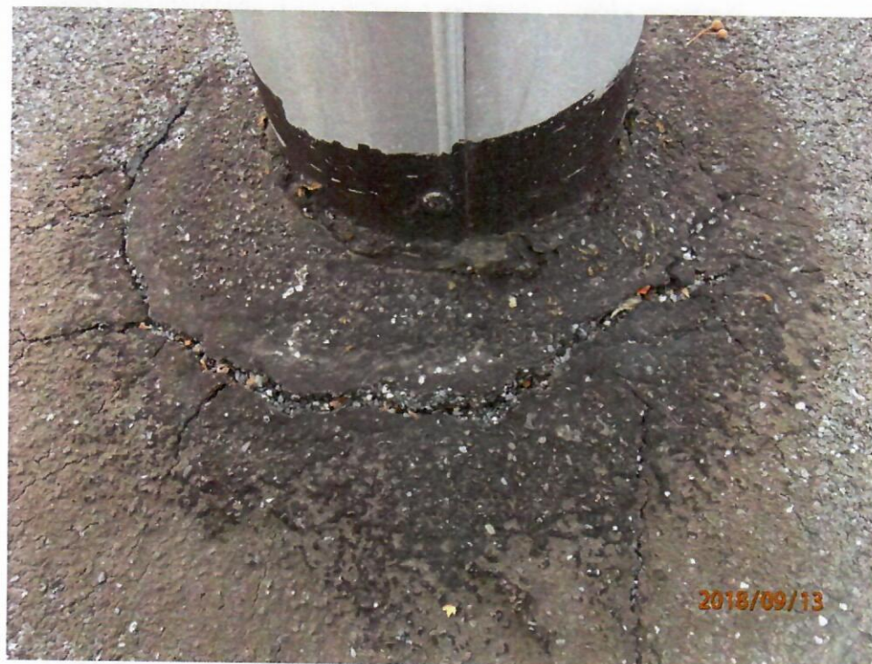
Fot. 10. Typowa usterka pokrycia z papy w miejscach przechodzenia wywiewzaków przez dach – prawdopodobna jedna z przyczyn nieszczelności pokrycia. Pęknięcie pokrycia z papy wskazuje na niską jakość użytego tego materiału. Nieprawidłowo wykonana obróbka wywiewki.
