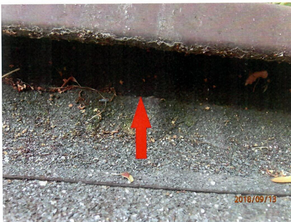
Fot. 5. Odklejony bądź nie przyklejony do pionowej ścianki attyki pas papy spowodowany niewłaściwą wysokością oraz brakiem odpowiednio wyprofilowanego narożnika pomiędzy dachem i attyką.
