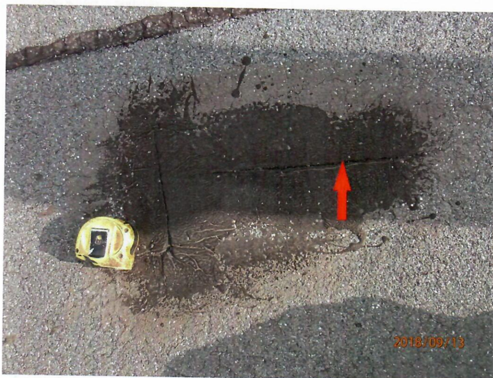
Fot. 20. Nieskuteczny sposób naprawy rozerwania papy poprzez smarowanie powłoką bitumiczną mało elastyczną. Uszkodzenie powinno być naprawione dodatkową łata przyklejoną w miejscu uszkodzenia pokrycia.
