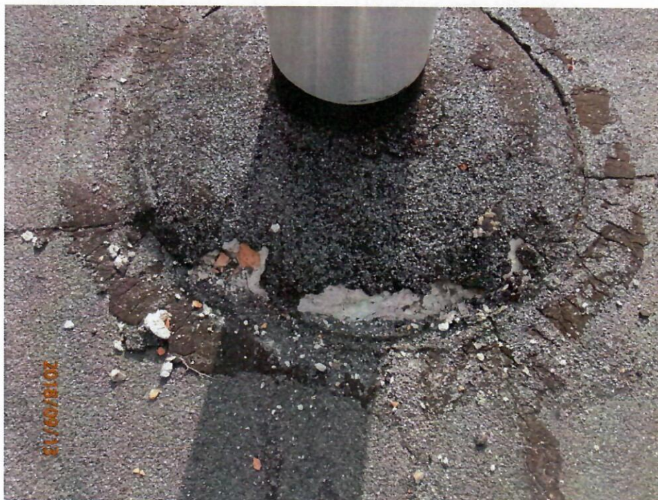
Fot.16. Inne miejsce przechodzenia wywiewzaka przez dach. Uszkodzenie powłoki bitumicznej – przyczyna przeciekania wody opadowej. Pęknięcie pokrycia z papy wskazuje na niską jakość użytego tego materiału. Nieprawidłowo wykonana obróbka wywiewki.
